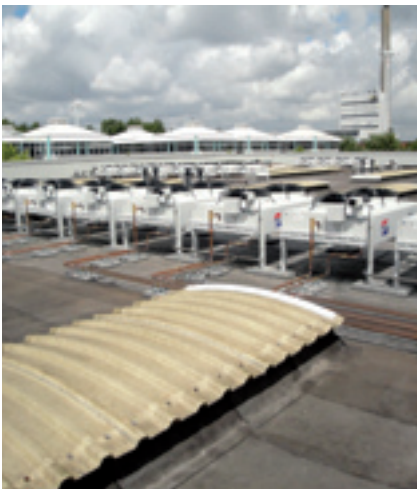
De dakopstelling van de condensoren.
